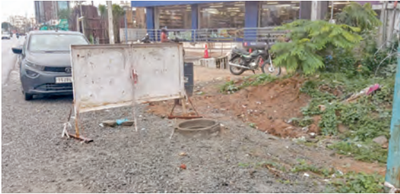
సాయికృష్ణ కాలనీల్ అసంపూర్తిగా వదిలేసిన రోడ్డు పనులు
